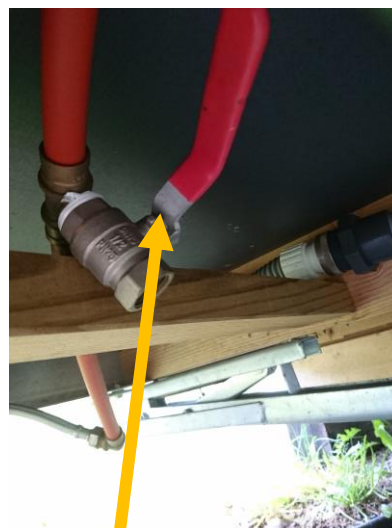
Purge d'eau Chaude
